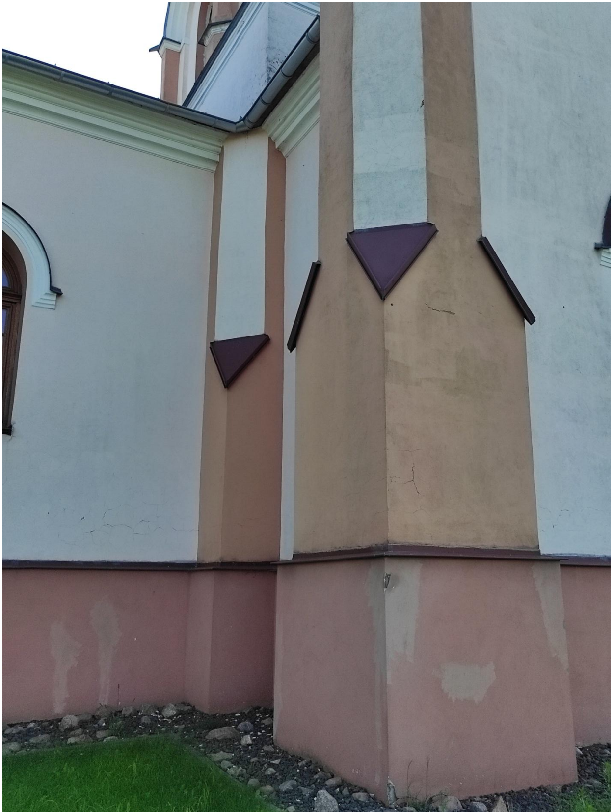
Fot. Nr8. Zabytkowy kościół w Kuryłówce. Widok stanu zachowania tynków elewacji
