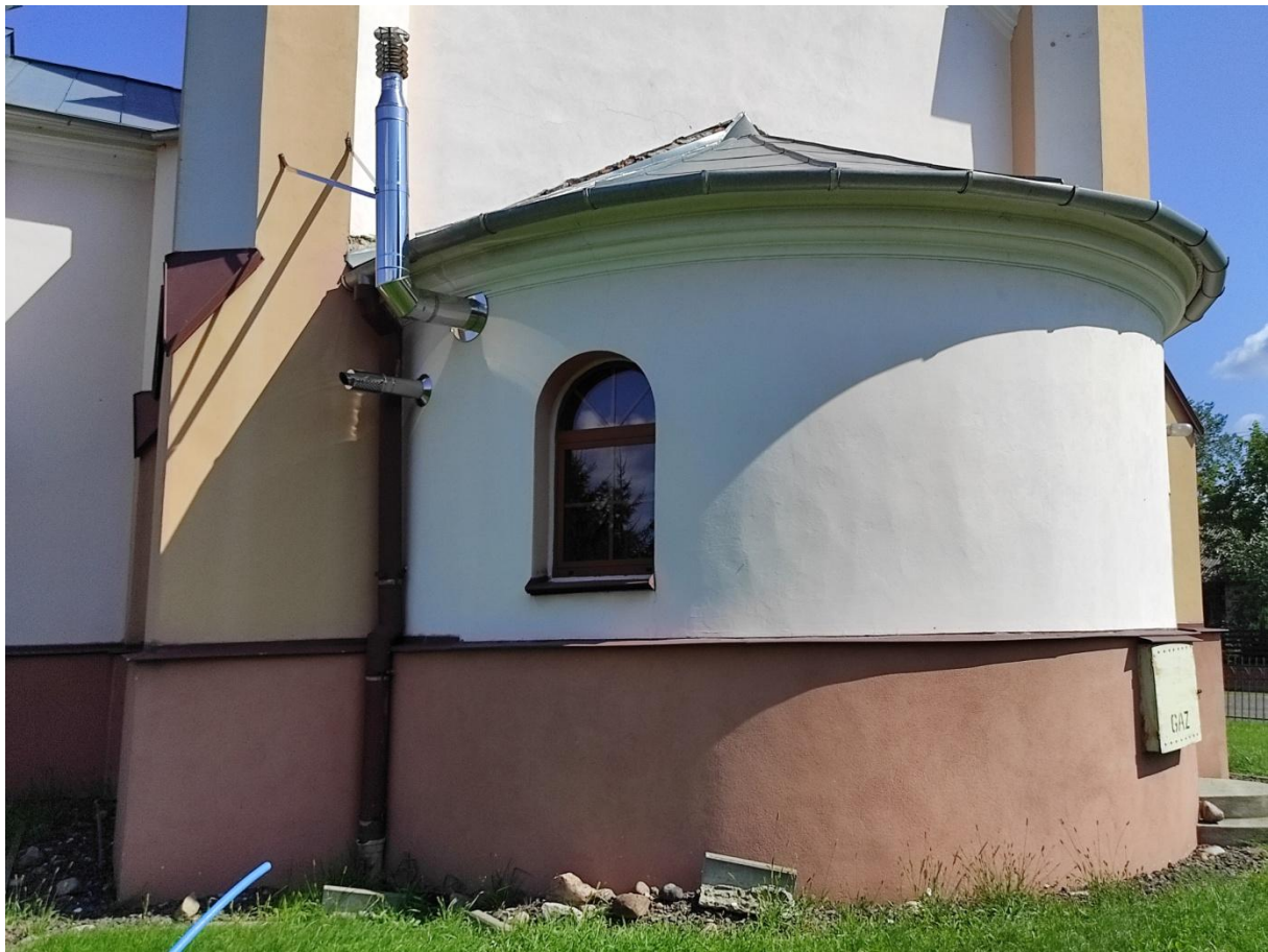
Fot. Nr9. Zabytkowy kościół w Kuryłówce. Widok stanu zachowania tynków elewacji
