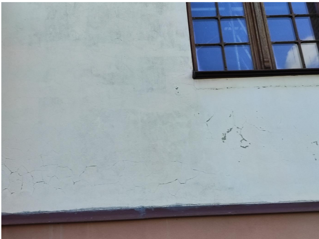
Fot. Nr6. Zabytkowy kościół w Kuryłówce. Widok stanu zachowania tynków elewacji
