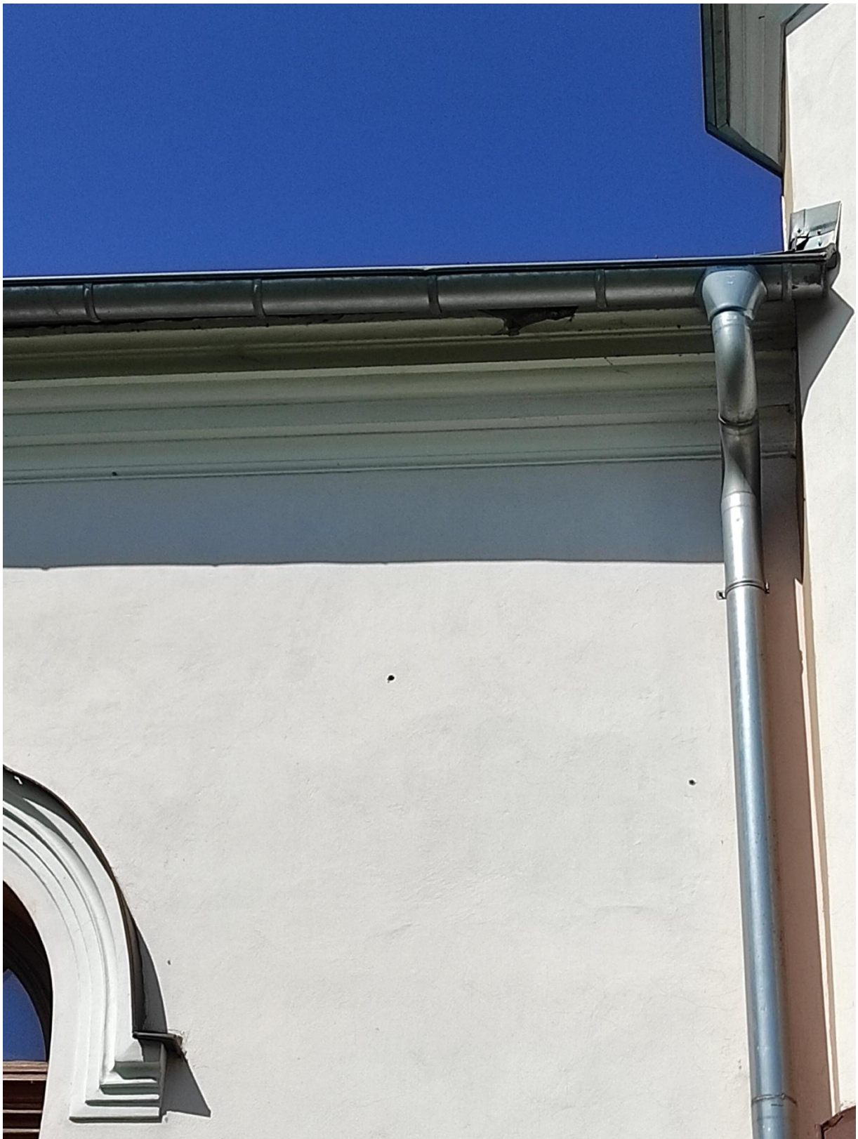
Fot. Nr10. Zabytkowy kościół w Kuryłówce. Widok stanu zachowania tynków elewacji
