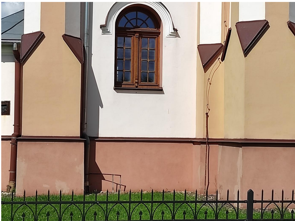
Fot. Nr7. Zabytkowy kościół w Kuryłówce. Widok stanu zachowania tynków elewacji
