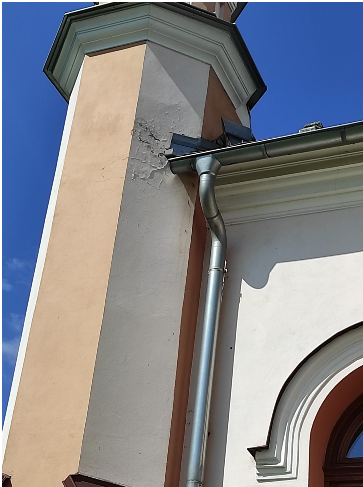
Fot. Nr9. Zabytkowy kościół w Kuryłówce. Widok stanu zachowania tynków elewacji
